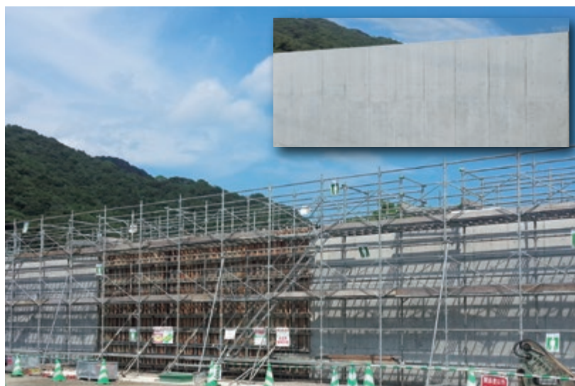
マジカルSKiPで型枠脱型時期を短縮したFBコンクリート防潮堤
